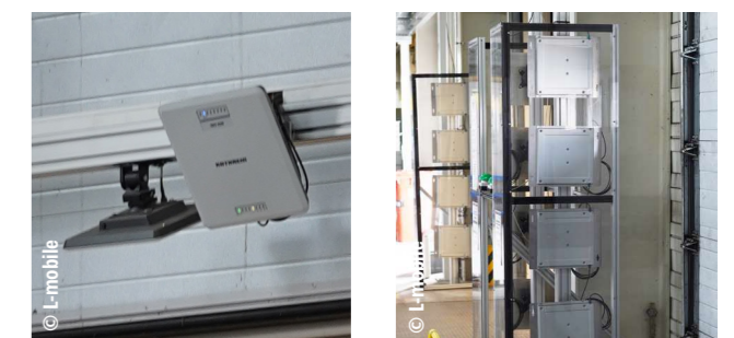
Abbildung: die KATHREIN RRU 4500 Reader wurden direkt über dem Verladetor angebracht, und die SSMH Antennen seitlich neben den Toren, um die getagten Pakete zu erfassen.
